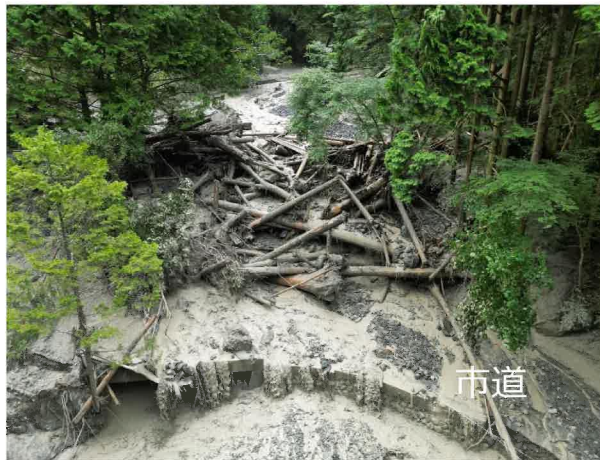
市道への流出状況
