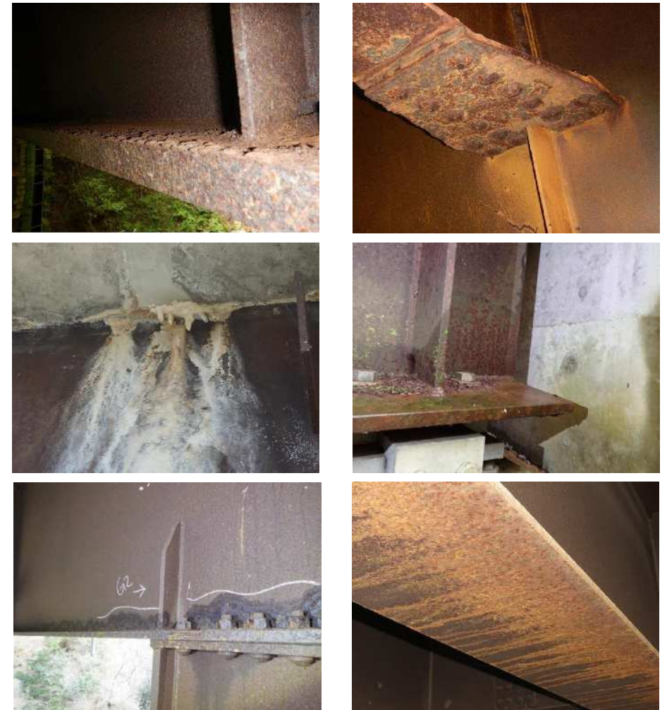
健全性Ⅱの劣化状況
