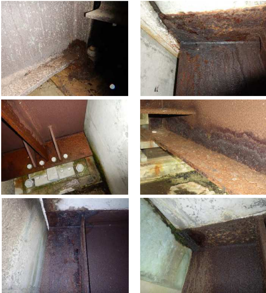
健全性Ⅲの劣化状況
