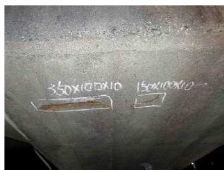
剥離・鉄筋露出
