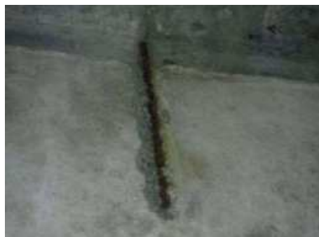
剥離・鉄筋露出
