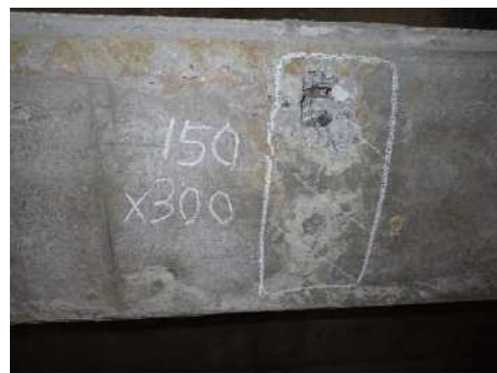
剥離・鉄筋露出
