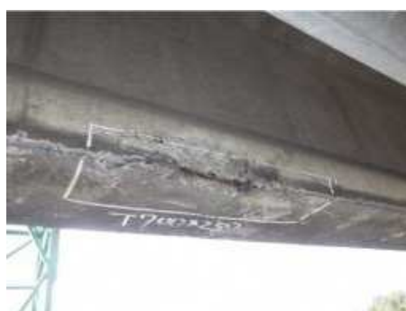
剥離・鉄筋露出
