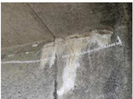
漏水・遊離石灰
