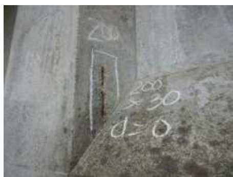
剥離・鉄筋露出
