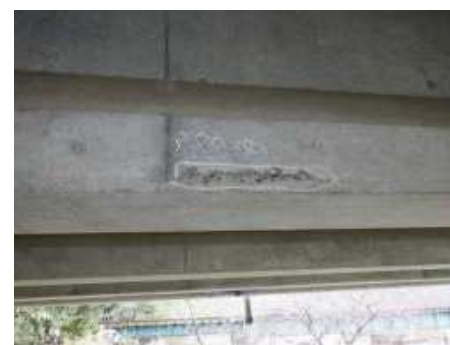
剥離・鉄筋露出
