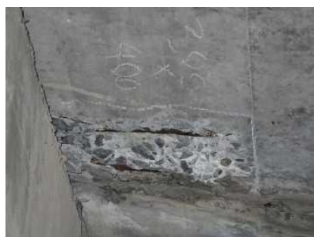
剥離・鉄筋露出
