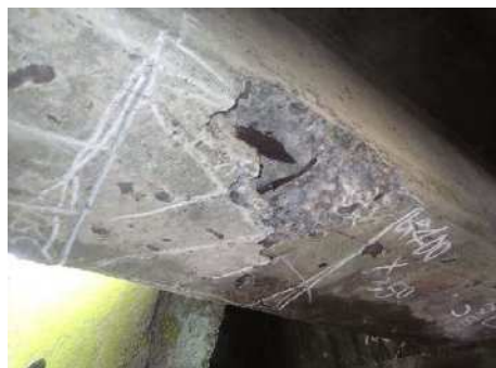
剥離・鉄筋露出
