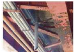
写真-3 下フランジ損傷例
