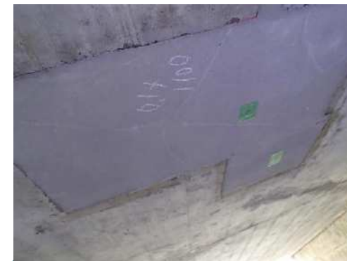
稲川橋・主桁・ひびわれ ⇒ ⑥断面修復材の収縮 ⑩養生不足
