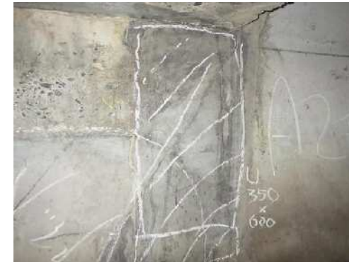
八幡橋・橋台・うき ⇒ ⑥断面修復材の収縮 ⑧下地処理不足 ⑩養生不足
