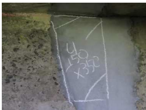
清水橋・橋台・うき ⇒ ⑥断面修復材の収縮 ⑪狭隘部等の施工
