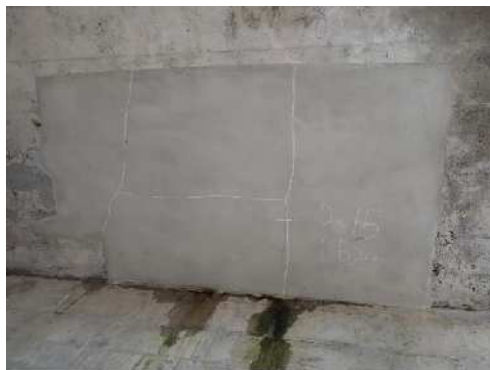
境沢橋・主桁・ひびわれ ⇒ ①原因除去不足 ⑥断面修復材の収縮 ⑪狭隘部等の施工
