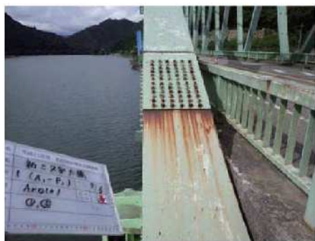
写真-2 連結板周辺の腐食事例
