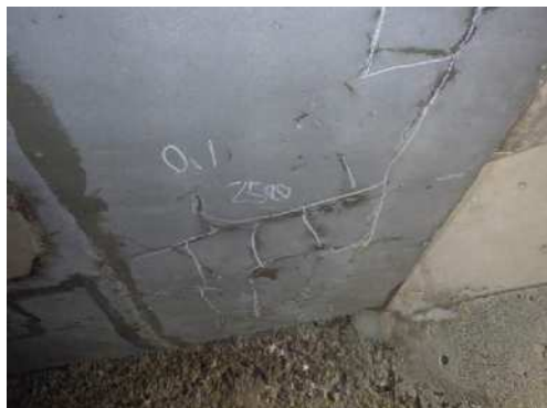
汐入橋・主桁・ひびわれ ⇒ ①原因除去不足 ⑥断面修復材の収縮
