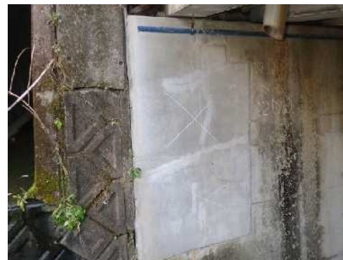
石窪沢橋・橋台・うき ⇒ ⑥断面修復材の収縮 ⑧下地処理不足 ⑩養生不足
