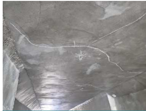
東松澤橋BOX 主桁・ひびわれ ⇒ ⑥断面修復材の収縮 ⑩養生不足
