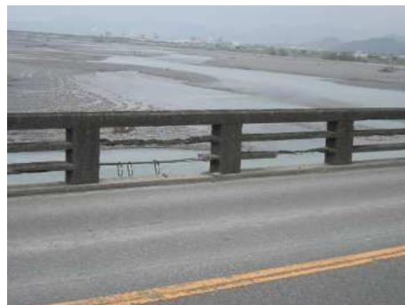
図 7.5 高欄部材の欠損
