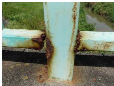
図 7.6 高欄の著しい腐食
