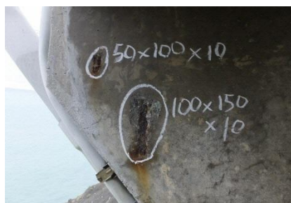
シェッド上部工の鉄筋露出
