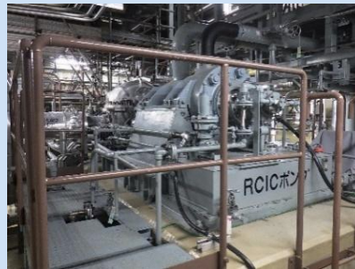
高圧注水設備 （タービン駆動）
