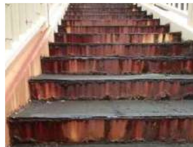
老朽化（継続的な補修）
