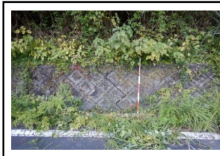
ブロック積の亀裂
