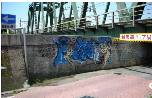
図 2-54 護岸への落書き -巴川 JR 橋付近-
