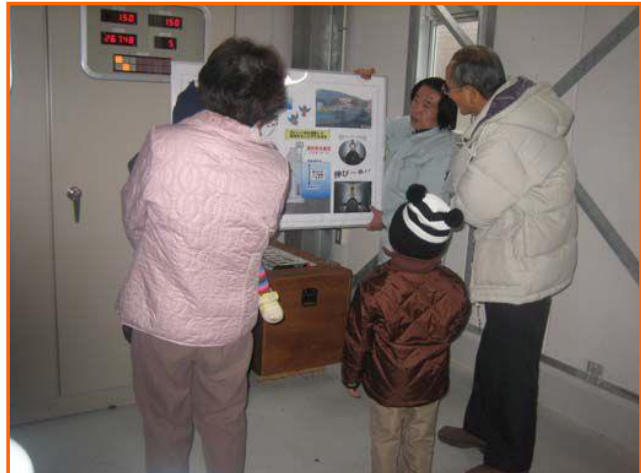
機械室（取水設備）（※普段は入れません）
