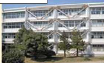
老朽化した校舎
