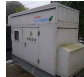
非常用発電機
