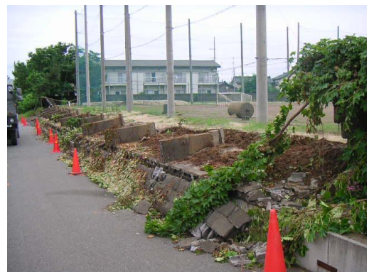
「倒壊したブロック塀（柏崎市）」
