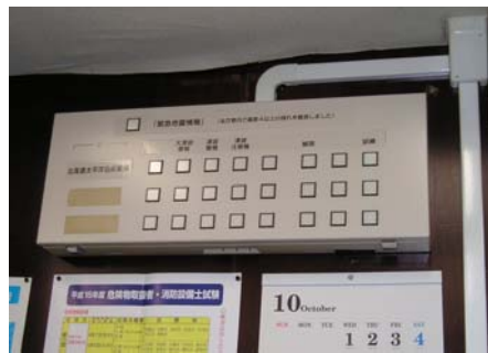
津波警報等緊急伝達システム表示盤
