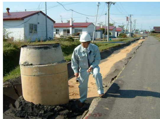
液状化による下水道施設の被害 周辺住宅の被害は無い (豊頃町)
