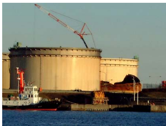
9/28に火災をおこしたタンク（右） （熱により変形し座屈している）
