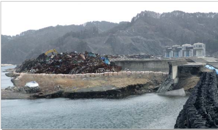
上) 大槌川水門・小鎚川水門の施工箇所 震災がれきの仮置場となっていた
