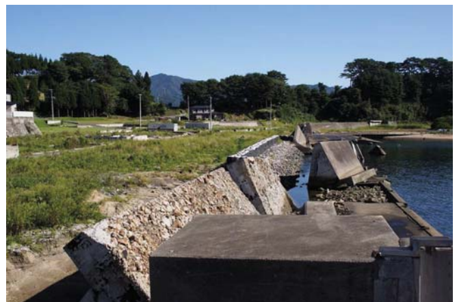
【入札不調となった緩傾斜堤の建設箇所】
