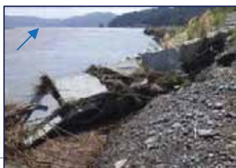
大槌川水門工事現場内の仮締切堤護岸の被災状況
