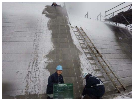
雪の中、出来形確認をする中戸川主査 防潮堤も雪化粧です
