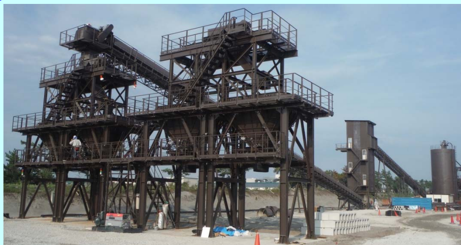
・CSGプラント（製造工場）
