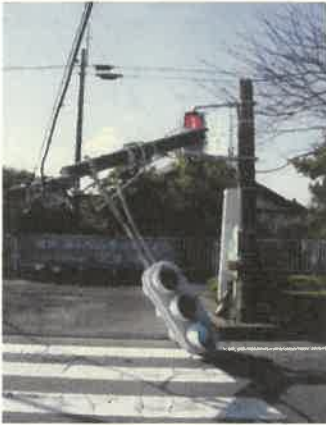
図5 「倒壊した信号柱」
