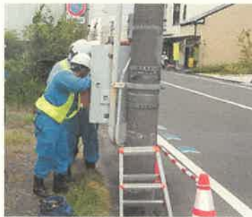
○信号制御機の点検
