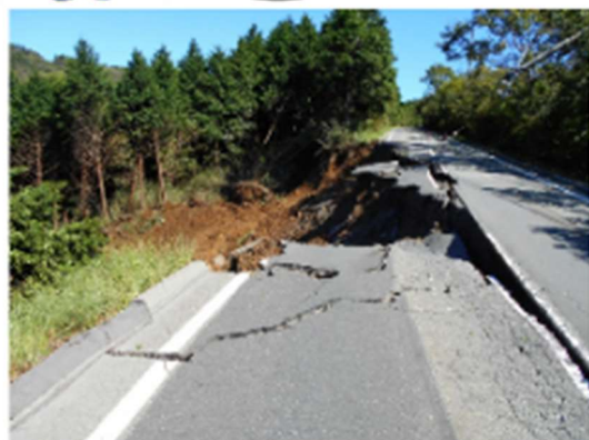
道路のくずれ (伊豆の国市浮橋)
